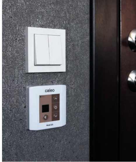
Рис. 20. Установленный терморегулятор на стене
